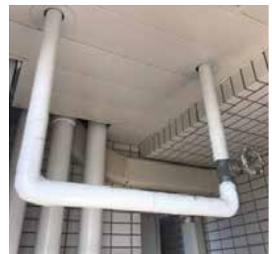
▲後陽台進水凸管
